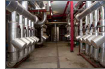
Sala de producción de frío-calor
