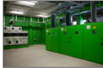
Centro de transformación.
