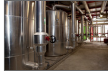
Sala de producción de agua caliente sanitaria
