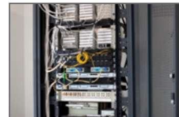
RTI. Rack de comunicaciones.
