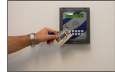
Control de acceso.
