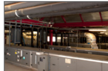
Unidad de tratamiento de aire de bloque quirúrgico. Bajo cubierta.
