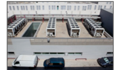
Cubierta del edificio industrial. Plantas enfriadoras.
