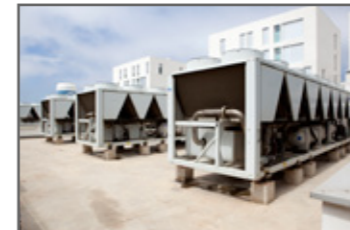
Cubierta del edificio industrial. Plantas enfriadoras.
