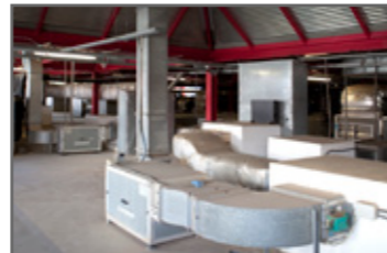
Renovación de aire de bloque quirúrgico. Chimeneas en cubierta.
